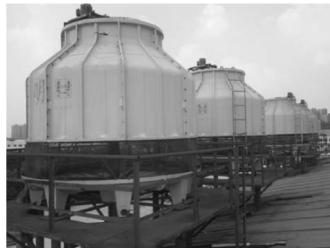
图3 循环用水系统的四组冷却塔，可按冷却用水量分别自动控制。
